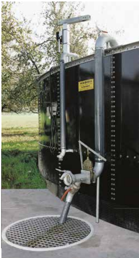
Saugleitung für Güllesilo
